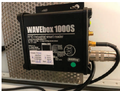
Wavebox des camions de collecte
