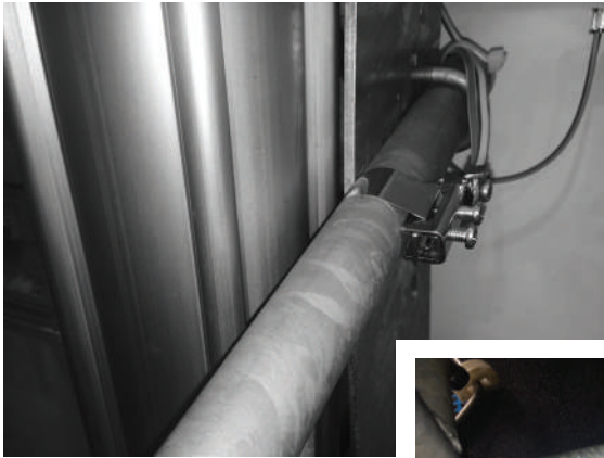
Mise à la terre
