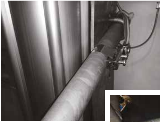
Mise à la terre
